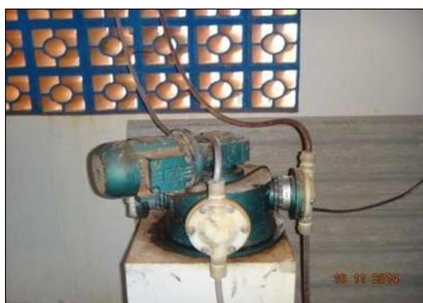
Figura 31 - Bomba dosadora Fonte: E.C.P. Soluções (2014).
