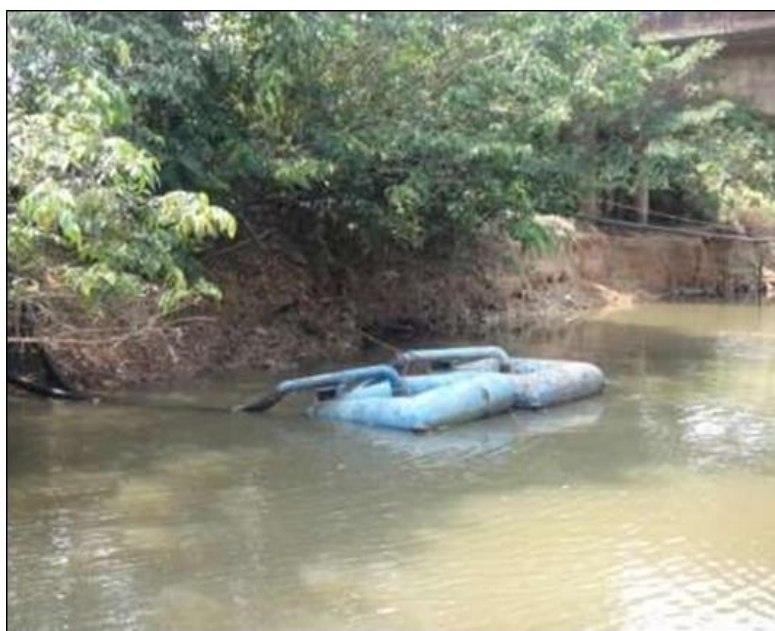
Figura 21 - Sistema de captação de água na Sede Municipal Fonte: E.C.P. Soluções (2014).
