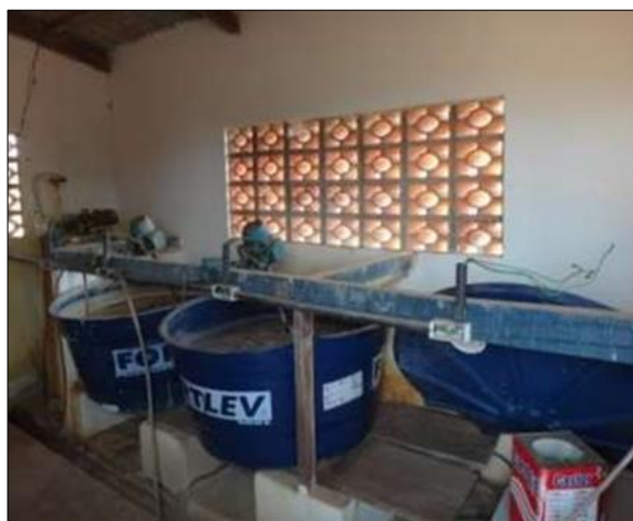
Figura 33 - Tanques de preparo dos produtos químicos Fonte: E.C.P. Soluções (2014).
