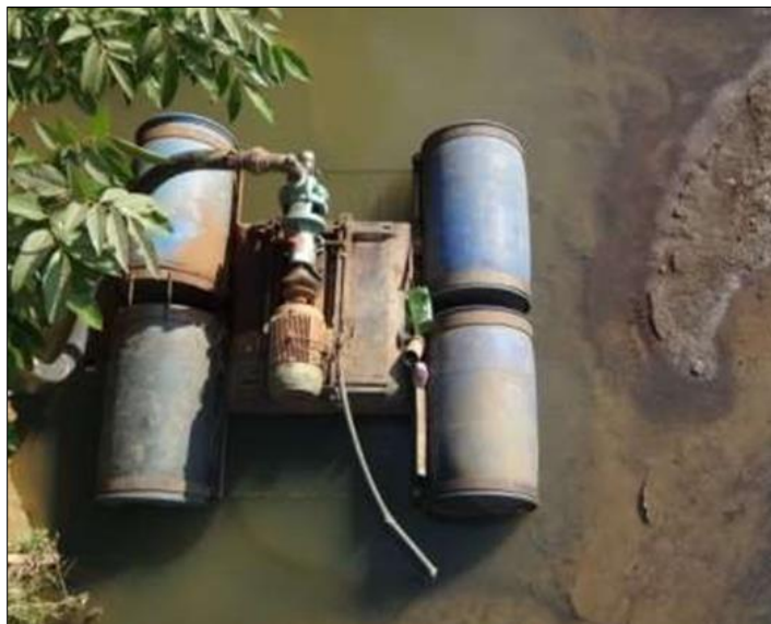
Figura 25 - Sistema de captação de água Fonte: E.C.P. Soluções (2014).
