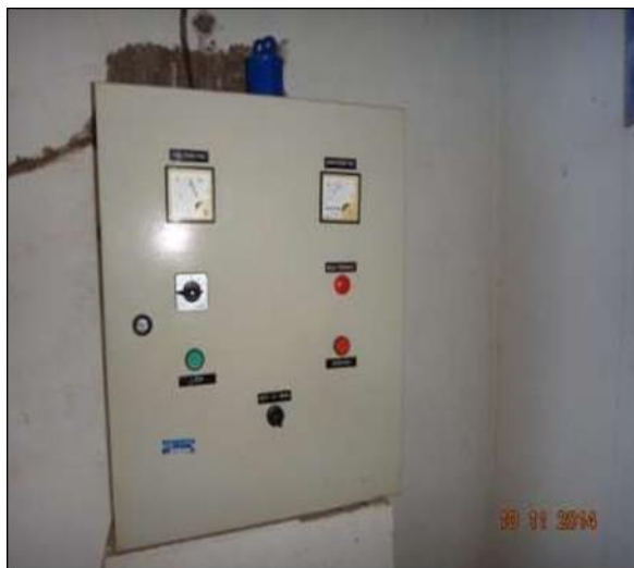
Figura 38 - Painel elétrico da EEAT
