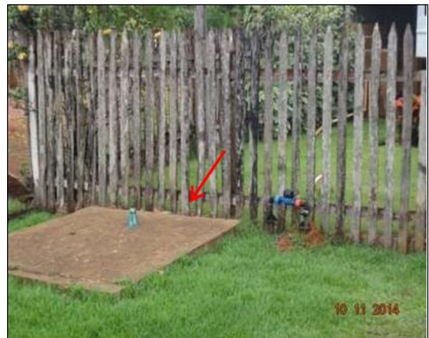
Figura 52 - Fossa negra para eliminar esgoto doméstico
