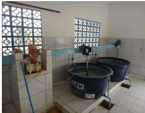
Figura 37 - Tanques de preparo dos produtos químicos
