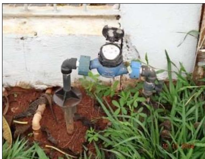
Figura 46 - Hidrômetro instalado na residência
